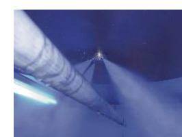
フォグテック社製 消火煙検知システム
