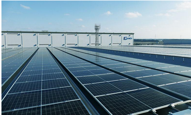
茨城県八千代町のエフピコ工場に設置した2.9MWの太陽光パネル
